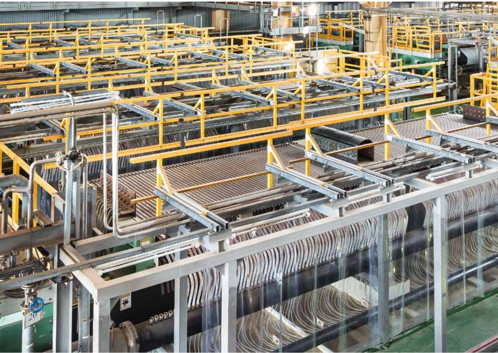
Zellensaal einer Chlor-Alkali-Elektrolyseanlage
