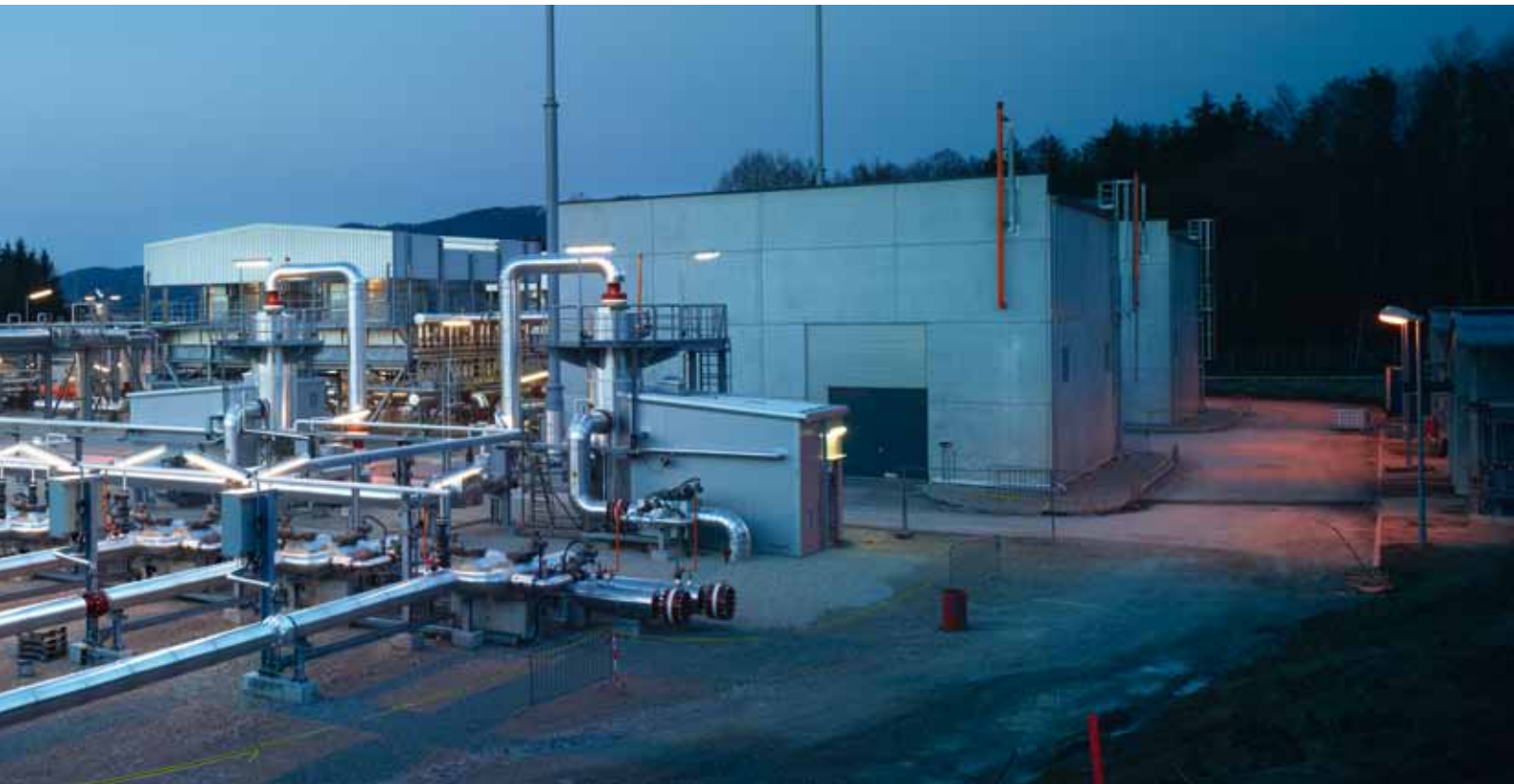
Porenspeicheranlage in Nussdorf
